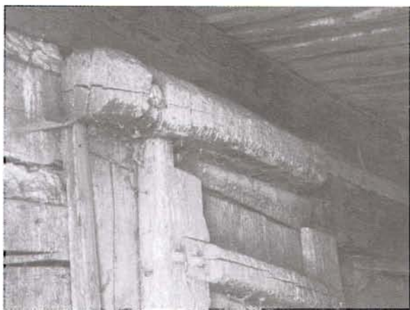
Obr. 8. Čistá u Litomyšle čp. 97, výměnek usedlosti. Detail trámku pro horní uchycení dveří dolní komory. Foto Z. Syrová, 2001. – Abb. 8. Čistá bei Litomyšl KNr. 97, Altenteil des Anwesens. Untere Kammer – Detail des Balkens für die obere Verankerung der Türangel. Foto Z. Syrová, 2001.
